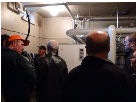
Kuva 1: Sonkakosken Urheiluseurantaloon, Koskelan maalämpöhanketta esitteli Hugo Makkonen. Kuva Koskelan pannuhuoneesta, jossa tutustuttiin uusiin maasta lämpöä varaaviin laitteisiin.
